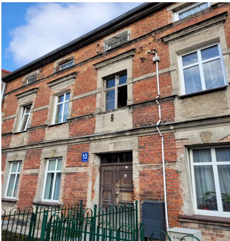
Fot. 21. Budynki w złym stanie technicznym na obszarze rewitalizacji
